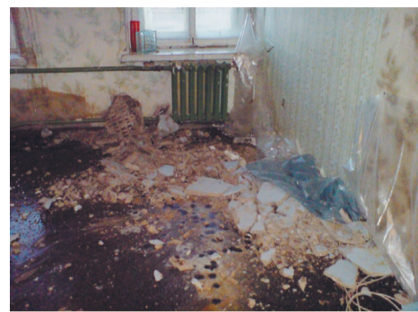
Последствия очередной протечки
