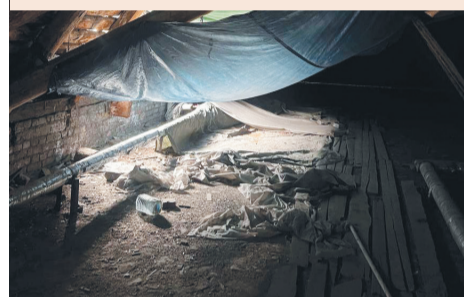
Тенты под крышей «защищают» от протечек
